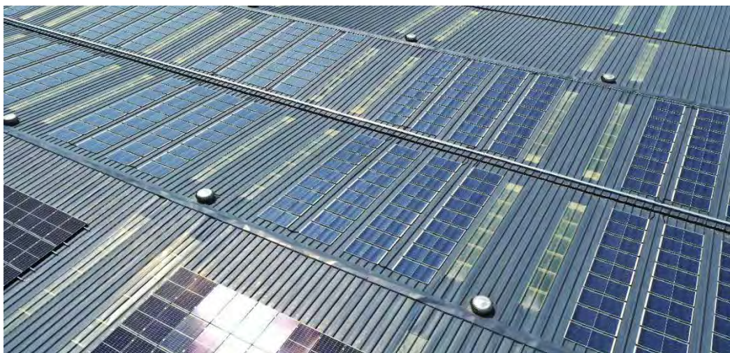
山西某工业园采用的赤晓科技光伏产品
